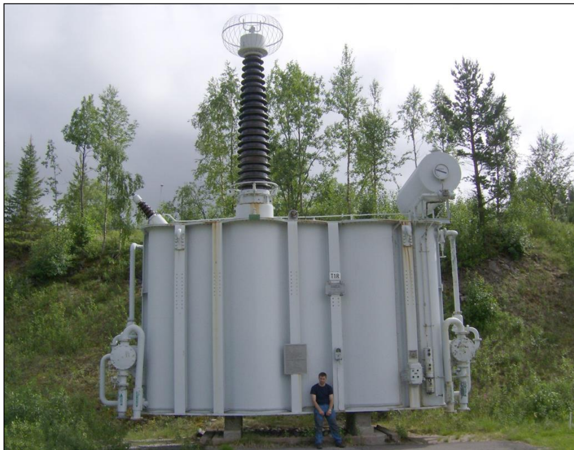
První transformátor na 400 kV na světě (elektrárna Porjus, Jokkmokk, Švédsko)
