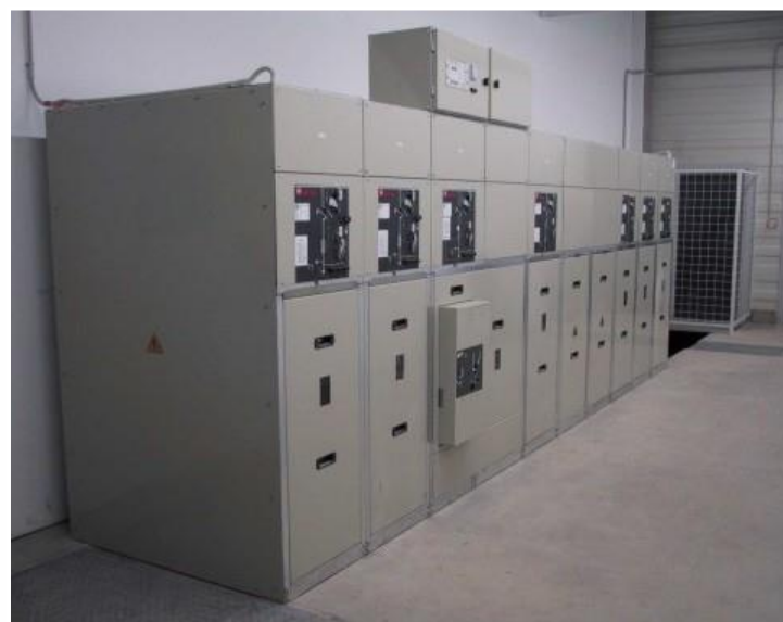
Zapouzdřená rozvodna 35 kV SF 6 .
