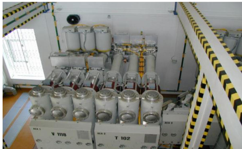
Zapouzdřená rozvodna 110 kV SF 6 .
