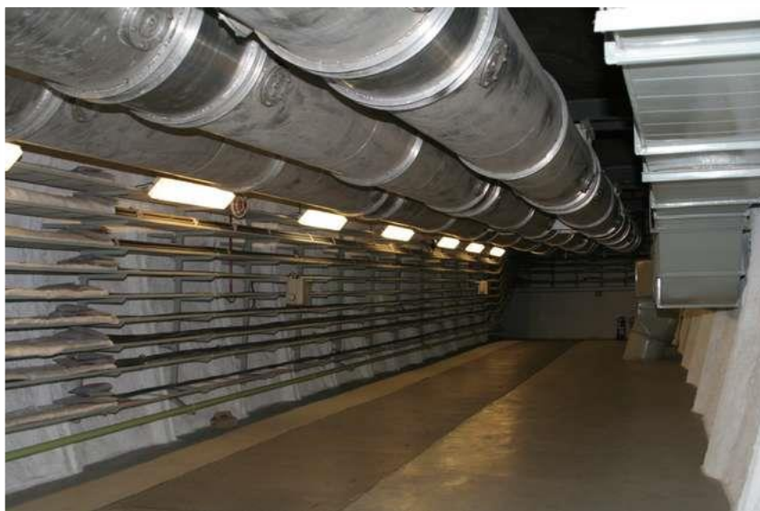
Třífázové zapouzdřené vedení 22 kV.
