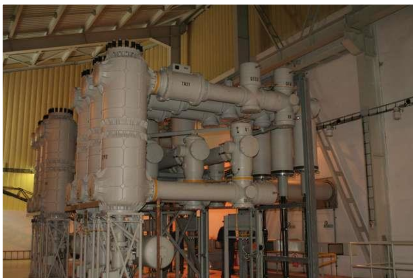
Zapouzdřená rozvodna 400 kV SF 6 (pro vyvedení výkonu elektrárny).
